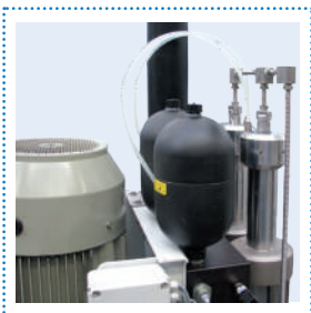
Accumulatore d'azoto per la gestione del circuito di ritorno dei cilindri idraulici
